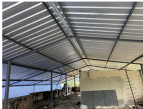
Ilustración 17: Colocación de cubierta en todo el edificio de la IE Héroes de Paquisha.
