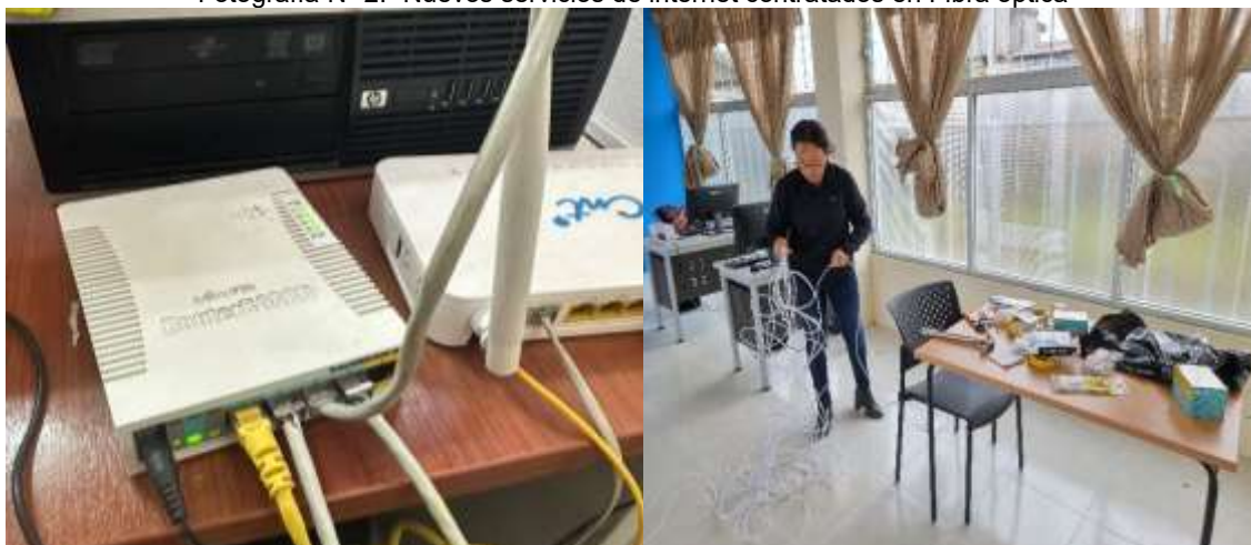
Fotografía N° 2.- Nuevos servicios de internet contratados en Fibra óptica
