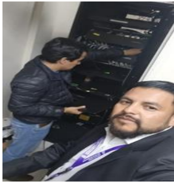
Mantenimiento Data Center Distrito 17D07
