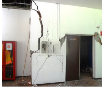
Ejemplo: La fisura de pared, amenaza la conexión que sale del tablero de distribución.
