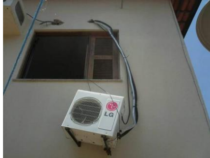
Ejemplo: un aire acondicionado de pared se encuentra en riesgo de caída
