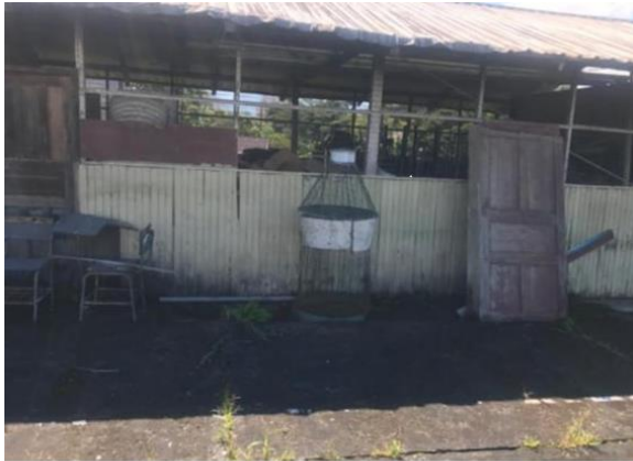
Aulas de madera en mal estado
