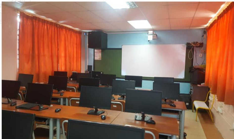
Ilustración N.7 Instalación en laboratorio de la Institución Educativa de la fibra óptica de CNT
