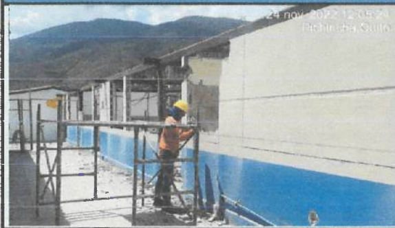
Derrocado de mampostería en bloque 19 panadería.
