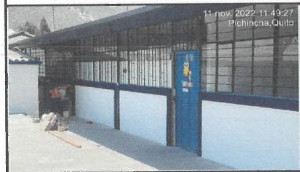
Pintura exterior en bloque 22. (color azul). ✓
