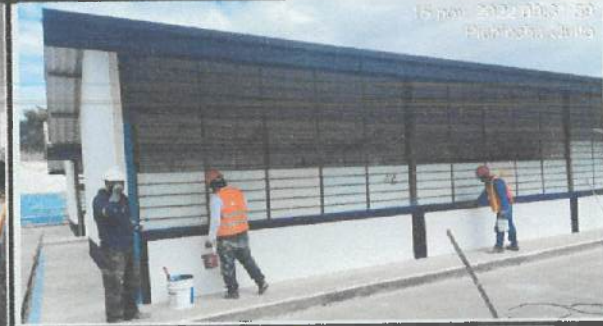
Pintura exterior en bloque 21 - 25. Color azul.
