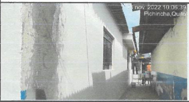
Empaste exterior en bloque 7.
