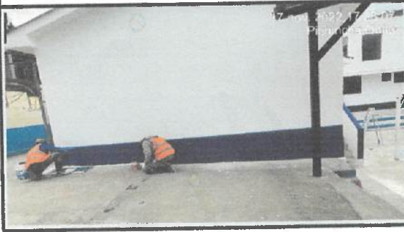
Pintura exterior en bloque 23, color azul.
