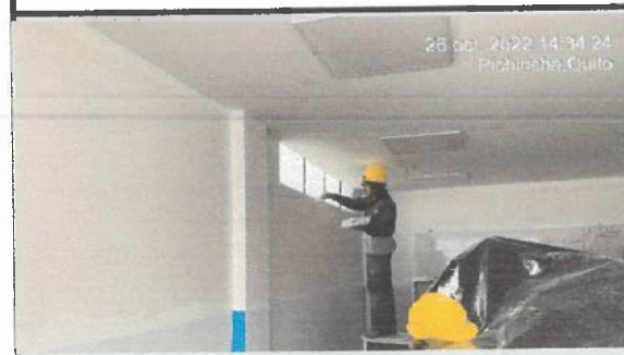
Empaste interior en bloque 33 (aulas).
