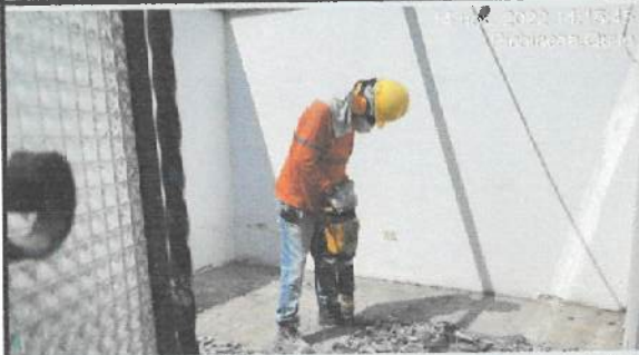
Derrocado de piso en bloque 19 panadería.
