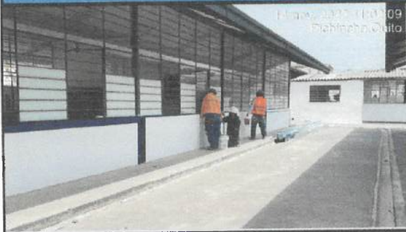
Pintura exterior en bloque 21 - 25 (color azul).
