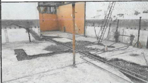
Relleno con material de mejoramiento en picado de contrapiso en bloque 19 panadería.
