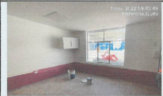
Pintura interior en bloque 34 (fallas).
