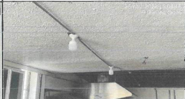
Instalaciones eléctricas en bloque 2.
