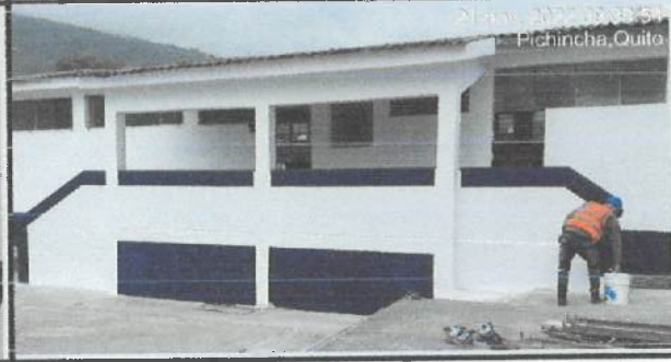
Pintura exterior en bloque 23, color azul.
