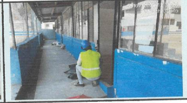
Empaste exterior (fallas) en bloque 32.
