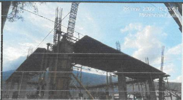
Encofrado de vigas en eje K - L - M (4 - 5 - 6) en bloque 19 aulas nuevas.
