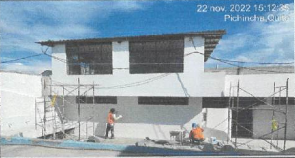
Empaste exterior en bloque 33, baños.
