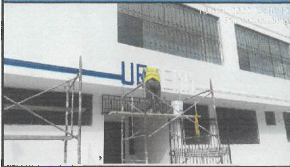
Pintura exterior en bloque 27, color azul.
