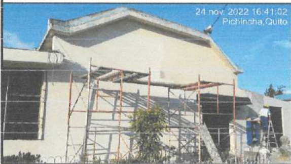
Empaste exterior en bloque 7.
