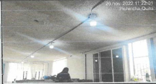
Instalaciones eléctricas en bloque 2.
