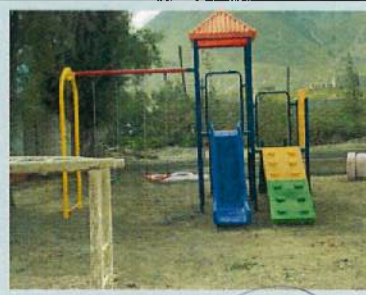
REPLANTEO Y NIVELACIÓN DE TERRENO PREVIO A INSTALACIÓN DE SET DE JUEGOS INFANTILES
