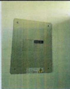
INSTALACIÓN CENTRO DE CARGA 8 ESP B12
