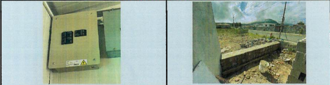
INSTALACIÓN DE CENTRO DE CARGA DE 8 ESPACIOS B9
