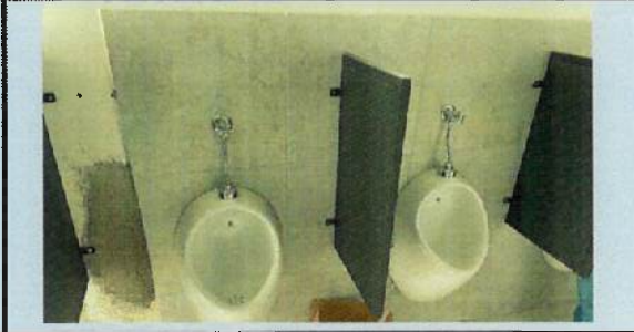
INSTALACIÓN DE PUERTAS DE TOL PARA DIVISIÓN EN URINARIO Y CUBÍCULOS DE INODOROS B12
