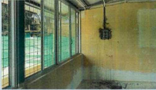
INSTALACIÓN CENTRO DE CARGA 8 ESP B6
