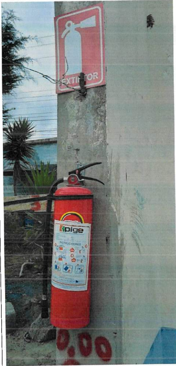
Extintor ubicado en área de obra
