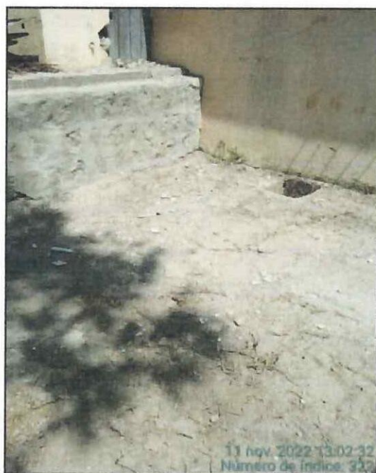
Disposición de espacio para escombros registro fotográfico 11 de noviembre 2022
