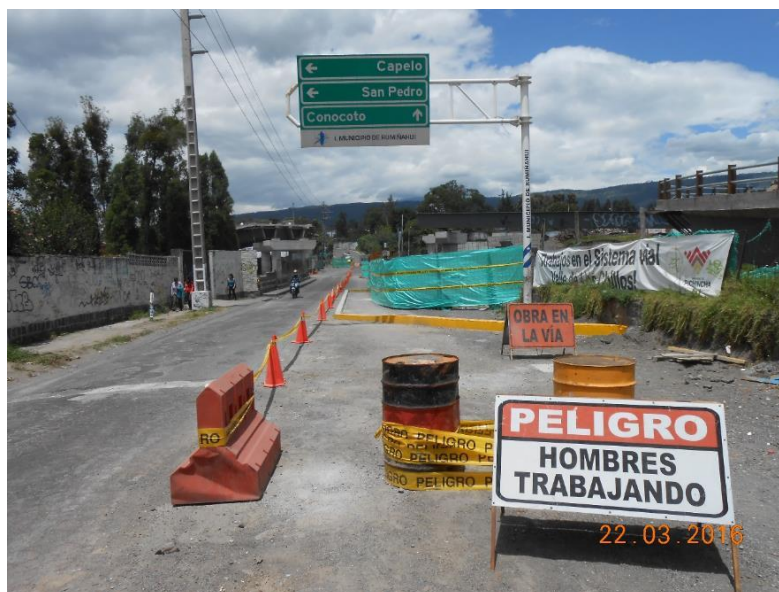
Foto No. 2: Ejemplo del uso de vallas y conos para señalización
