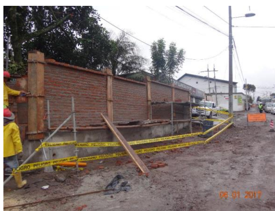
Foto No. 2: Ejemplo del uso de cintas plásticas de peligro
